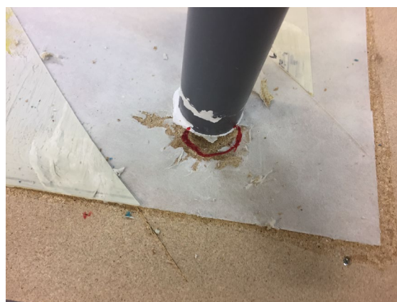
Läckage vid litet avloppsrör
