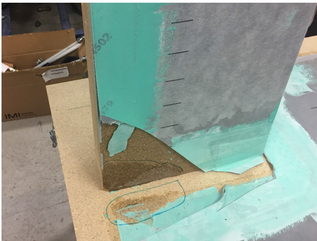
Läckage vid innerhörn
