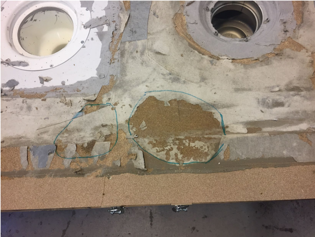
Läckage vid golv/väggvinkel
