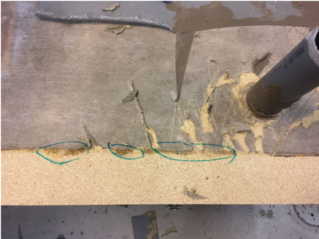
Läckage vid golv/väggvinkel
