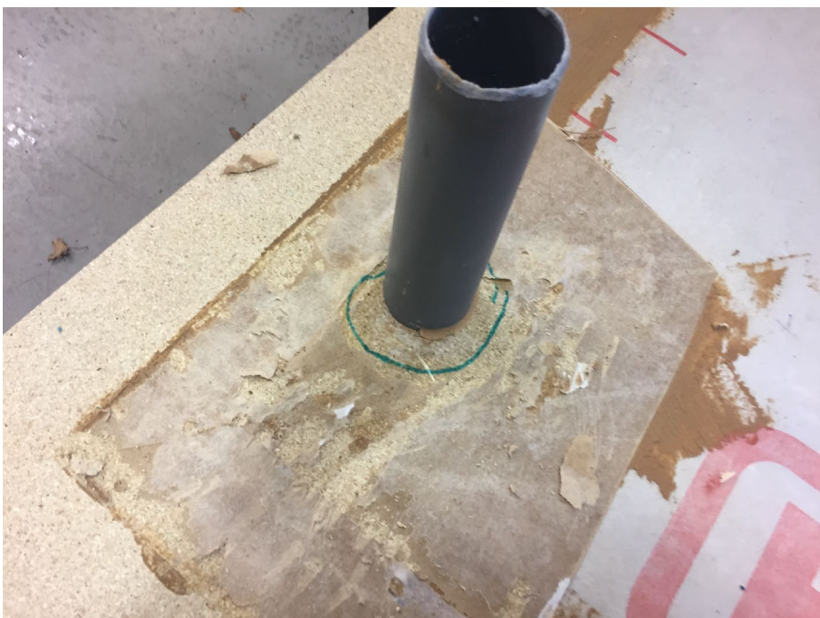
Läckage vid litet avloppsrör
