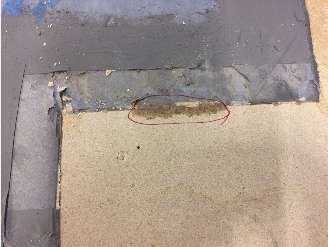
Läckage vid golv/väggvinkel
