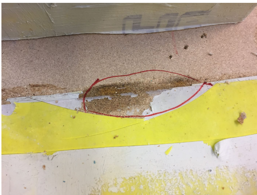
Läckage vid golv/väggvinkel
