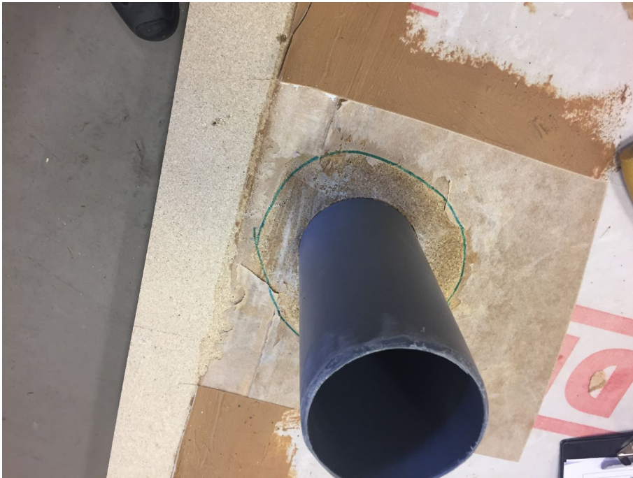
Läckage vid stort avloppsrör
