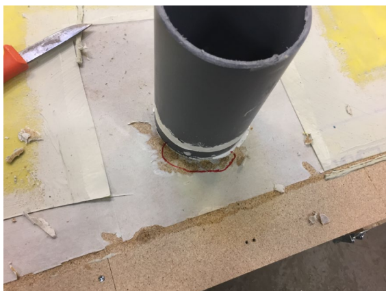
Läckage vid stort avloppsrör
