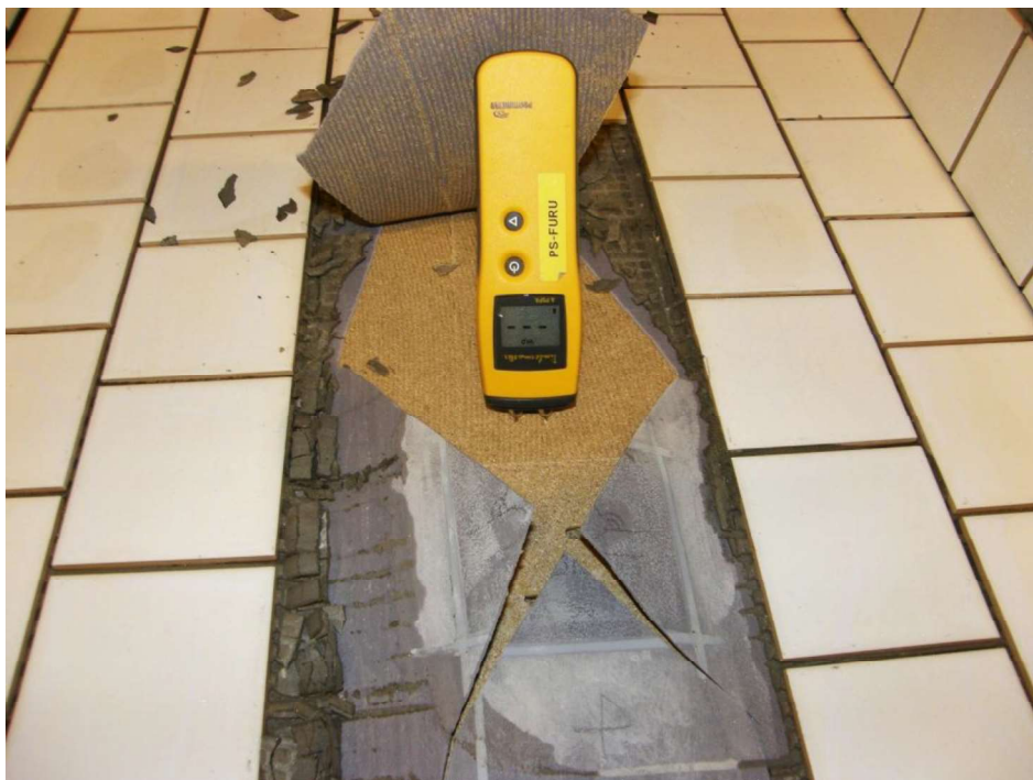
Fotografi 29. Inget synligt läckage och lågt fuktvärde i spänskivan.
