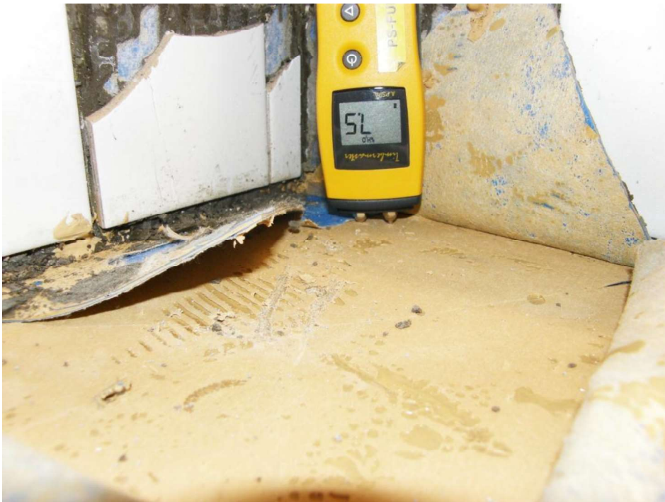
Fotografi 25. Inget synligt läckage och lågt fuktvärde i spånskivan.
