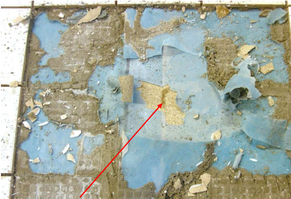
Fotografi 11. Litet läckage vid vådskarv redan innan någon delreparation har utförts.
