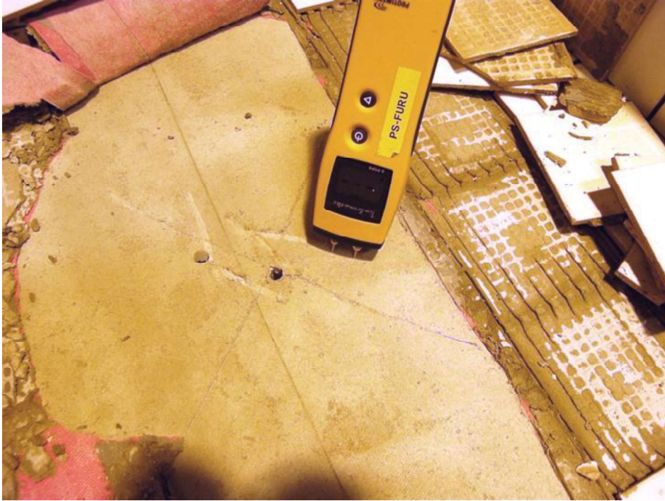
Fotografi 23. Inget synligt läckage och lågt fuktvärde i spånskivan.
