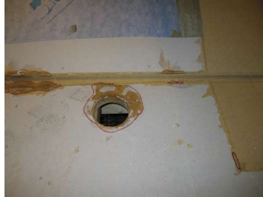
Läckage vid golv-väggvinkel och rör DN110, punkt 2 och 13.
