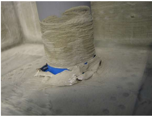
Dålig vidhäftning mellan produkten C och rörmanschett DN50.
