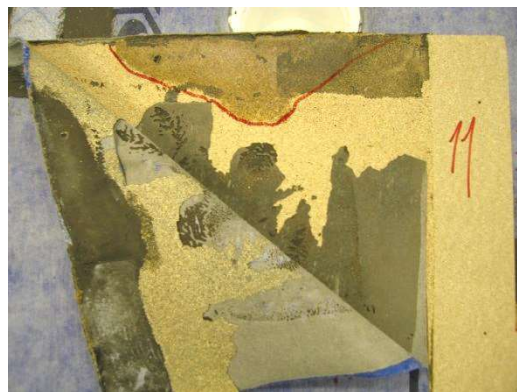
Läckage i väggdelen i punkt 11 bakom Jafobrunnen.
