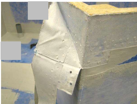
Blött under skarvremsor vid ytterhörn, det är dock torrt i underliggande spånskivor.
