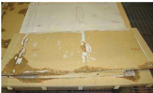
Blöta partier kring väggskarvar på kortsida mellan Purus- och Jafobrunnen.
