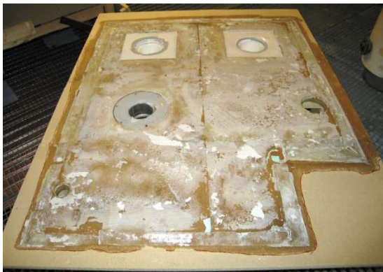
Blöta golvpartier efter borttagning av tätskiktet.
