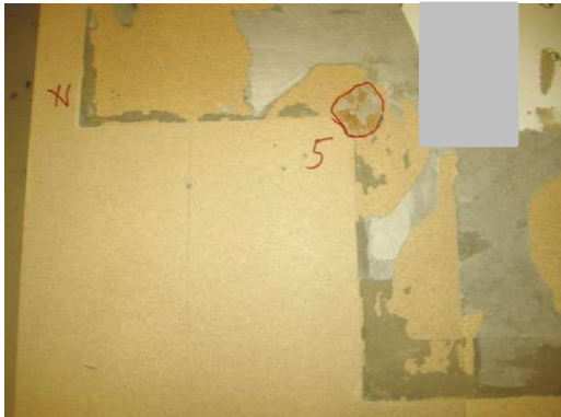
Läckage mot golvet vid ytterhörn, diameter ca 5 cm.
