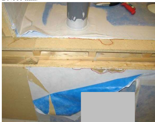
Blött parti i golv-väggvinkel bakom avloppsröret DN110 mm.
