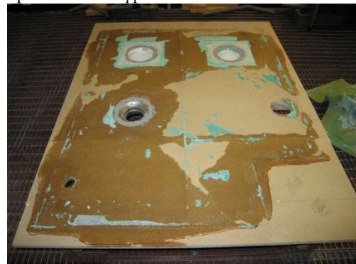
Blöta partier på golvet efter rivning.
