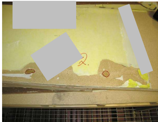
Två små fuktiga partier på väggen bakom avloppsrör 110 mm.
