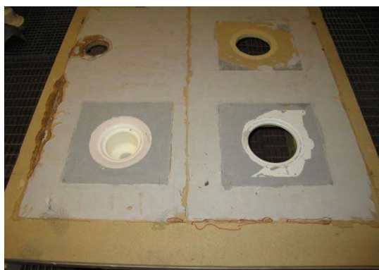
Översiktsbild över golvet efter rivning, läckageställen är rödmarkerade.
