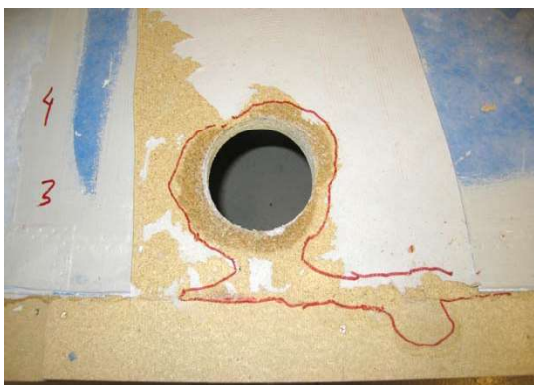
Blött parti på golvet kring avloppsröret DN110 mm.
