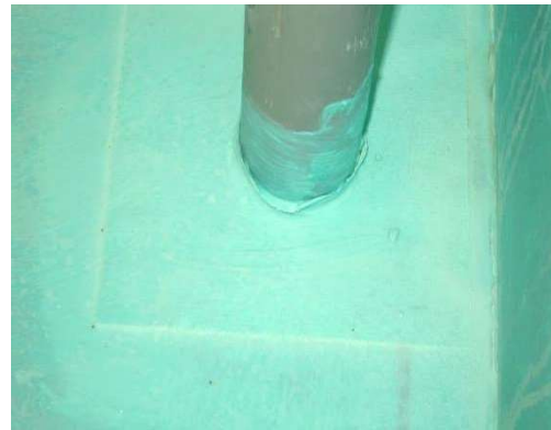
Sprickor vid avloppsrör 110 mm.
