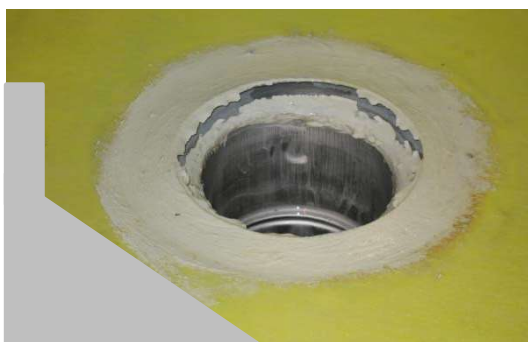
Blücherbrunnen, separation mellan brunnsmanschetten/folien och den rostfria brunnen.
