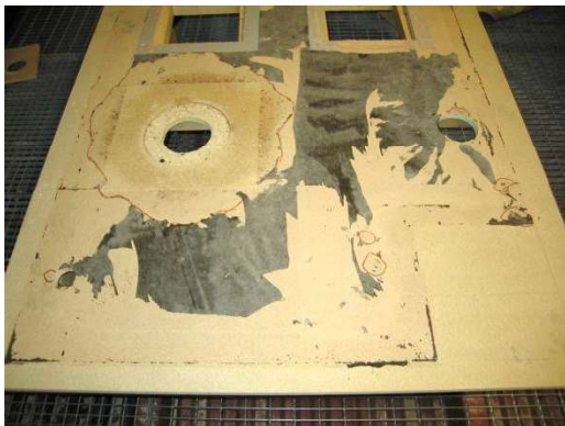
Samtliga läckage på golvet.
