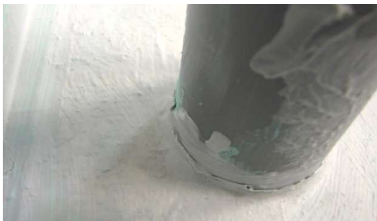
Spricka i tätskiktet mellan lilla avloppsröret DN50 och brunnsmanschetten.
