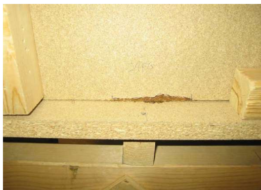
Läckage utsida bakom Jafobrunnen efter första vattenfyllning.
