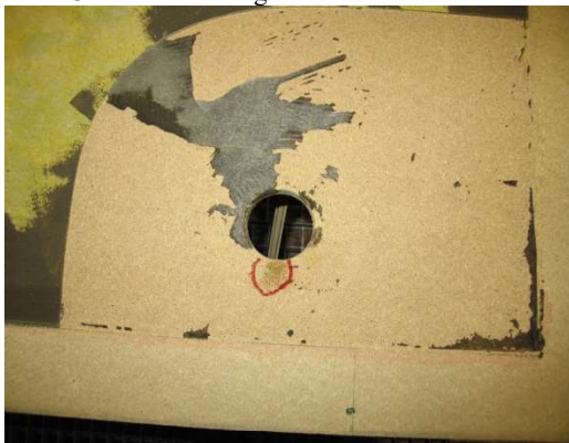
Punkt 14: Litet läckage vid lilla avloppsröret.
