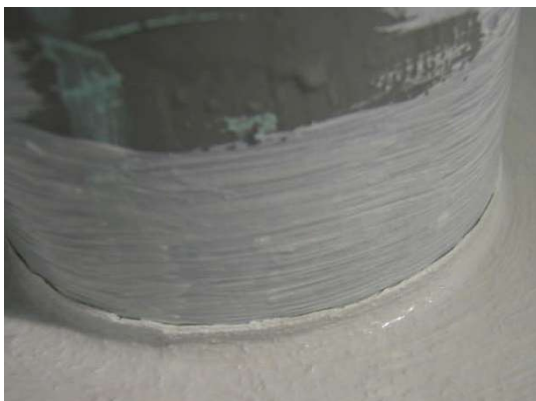
Spricka i tätskikt mellan lilla avloppsröret DN50 och brunnsmanschetten.
