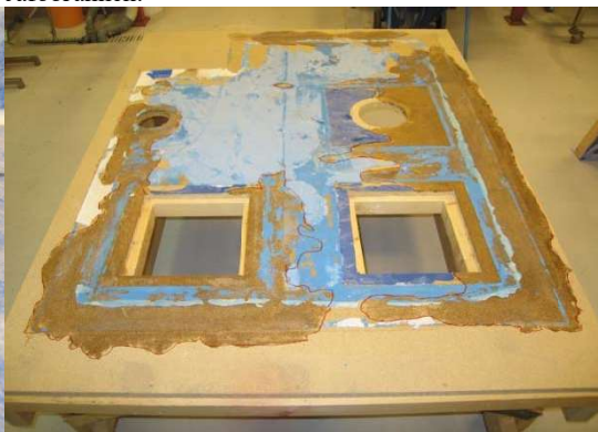
Stora blöta partier på golvet vid rivning av tätskiktet.
