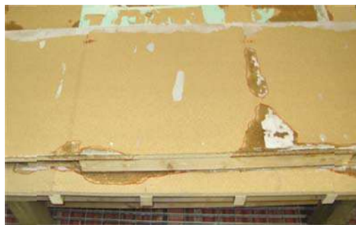
Blöta partier kring väggskarvar på långsida mellan Jafobrunnen och avloppsrör DN50.
