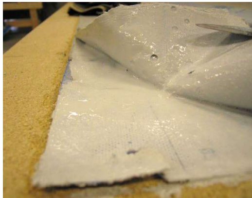
Blött under skarvremsor vid innerhörn, det är dock torrt i underliggande spånskivor.
