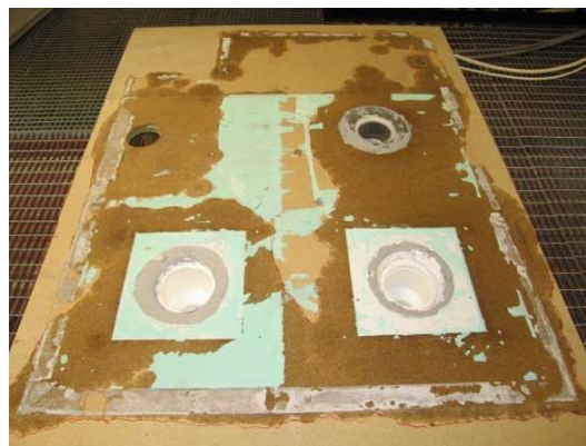
Blöta golvpartier efter borttagning av tätskiktet.
