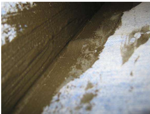
Veck på golvfolien vid golv-vägg vinkeln före provstart. Vecket tätades av SP före provstart.
