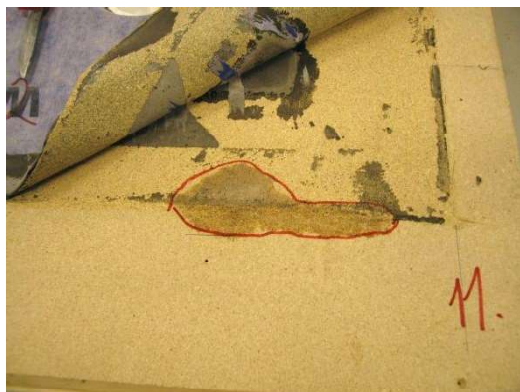
Läckage i golv i punkt 11 bakom Jafobrunnen.
