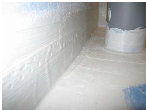
Veck i skarvremsan på golvet bakom avloppsröret DN110 mm.
