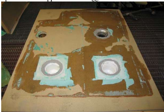
Blöta partier på golvet efter rivning.
