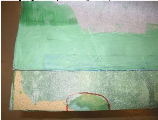
Mindre fuktigt område på vägg bakom DN50 rör (punkt 9).
