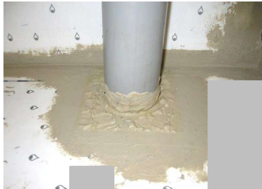
Limmet fäster inte mot den stora rörmanschjetten, det uppstod dock inget läckage.
