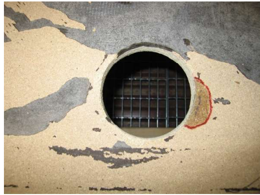
Punkt 13: Litet läckage vid stora avloppsröret.
