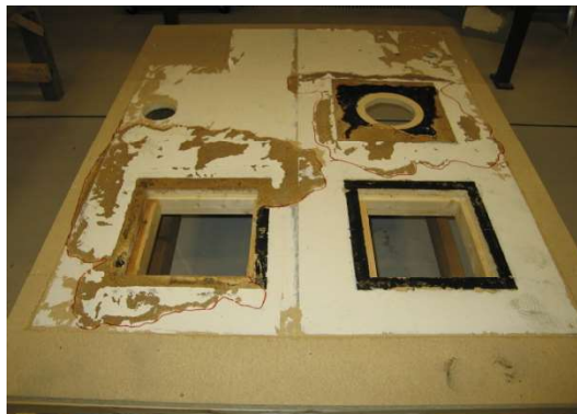
Hela golvytan efter rivning av tätskiktet, två stora läckageställ rödmarkerade.
