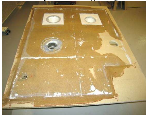
Blöta golvpartier efter borttagning av tätskiktet.
