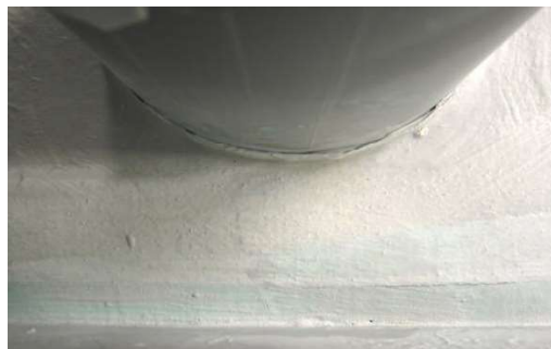
Spricka i tätskiktet mellan stora avloppsröret DN110 och brunnsmanschetten.
