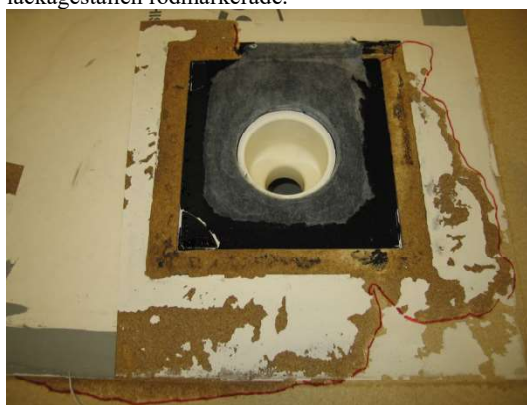
Blött på tre sidor runt monteringsplattan vid Purusbrunnen.
