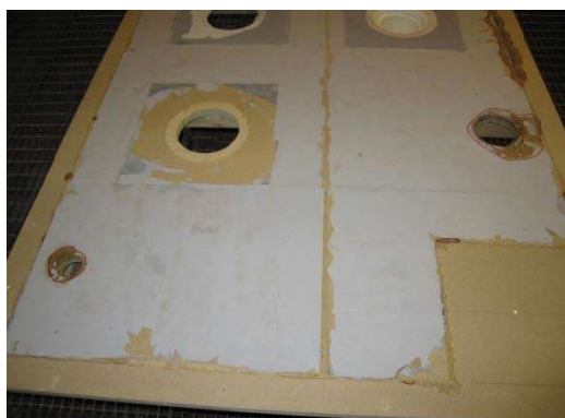
Översiktsbild över golvet efter rivning, läckageställen är rödmarkerade.
