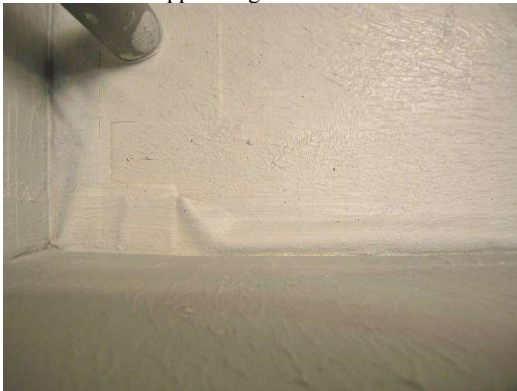
Självhäftande skarvremsa i golv-vägg vinkeln har fått stora bubblor och släppt från golvet.
